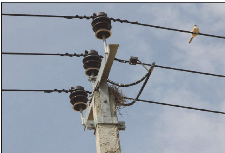
Опора ВЛ 10 кВ катодной защиты трубопровода «Тенгиз – Новороссийск», принадлежащей компании «Каспийский трубопроводный консорциум», в низовьях р. Эмба, оборудована самонесущим изолированным проводом (СИП-3) на штыревых изоляторах. Данная конструкция практически исключает возможность гибели птиц от поражения электрическим током и является оптимальной. Фото М. Пестова.
